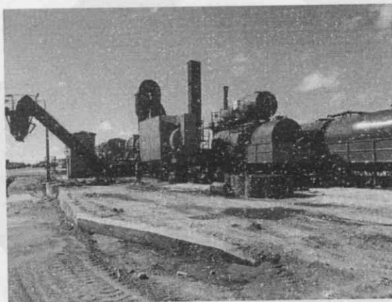
Foto 05 – Usina de Asfalto instalada nas dependências da empresa.
