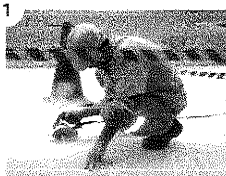
A etapa é realizada pelo Engenheiro de Obras com os profissionais de retrógrada de concreto. Estes devem ser fornecidos com uma de aço diamantada, com o qual o concreto de alta qualidade deve ser aplicado. A profundidade do corte deve ser especificada
