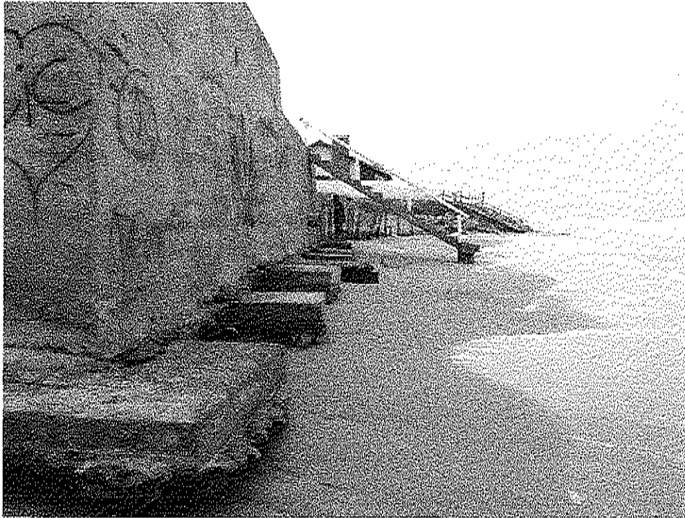
Figura 15 – Fundação exposta devido ao rebaixamento do terreno natural provocado pela impermeabilidade da estrutura.
