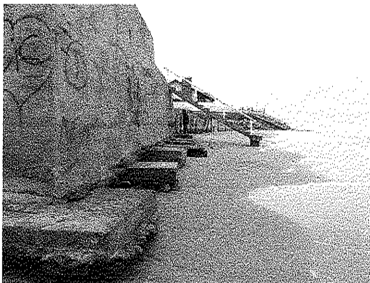
Figura 18 – Fundação exposta pelo rebaixamento do terreno natural causado pela impermeabilidade da estrutura.
