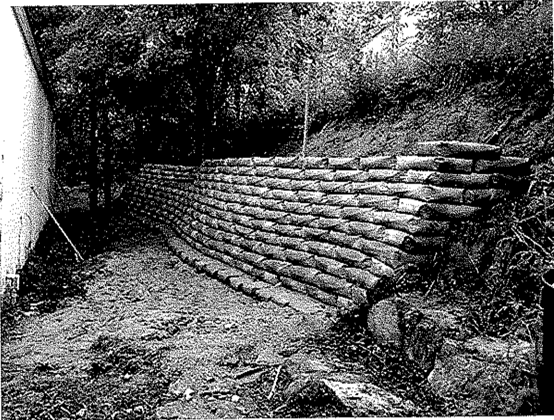
Figura 102: Uso adequado de Bagwall (ou bolsacreto) no controle da erosão do solo e contenção de encostas.
