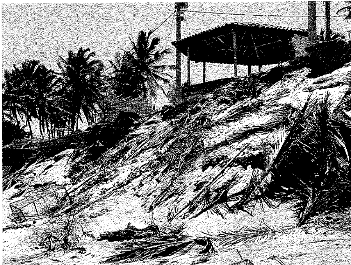
Figura 42: Coreto que se encontrava afastado 17,40 metros da linha de costa, na praia de Peroba, Icapuí, atualmente em processo de desmoronamento (2018).
